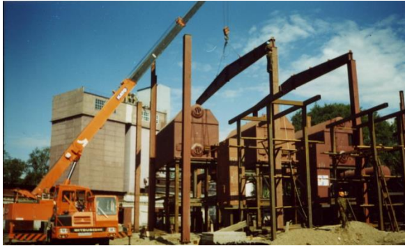
ОАО "Амурагроцентр" было осуществлено строительство котельной с тремя котлами КЕ-10-14-225
